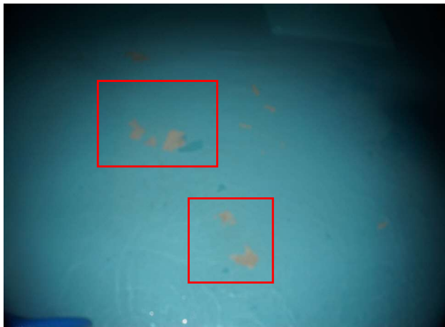
배수지2지 바닥슬래브 도장박리
