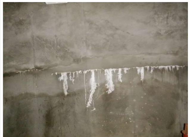
유출배관실 벽체 균열부백태
