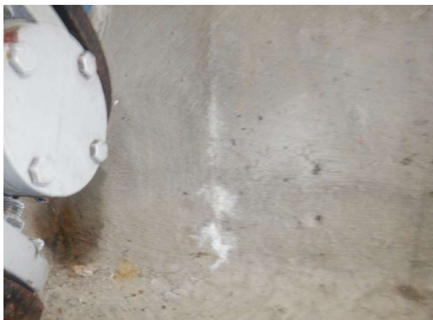
유입배관실 벽체 백태
