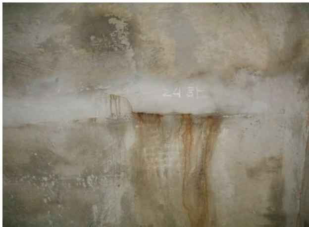
유출배관실 벽체 녹물흔적
