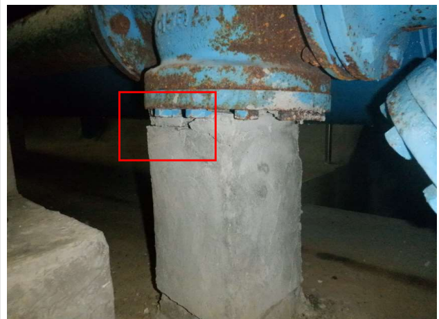
유입배관실 받침콘크리트 파손
