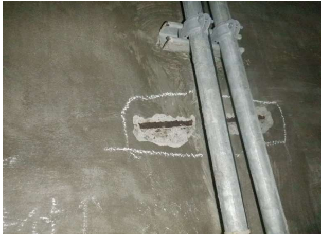
유입배관실 벽체 철근노출
