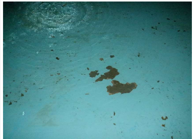
배수지1지 바닥슬래브 도장박리
