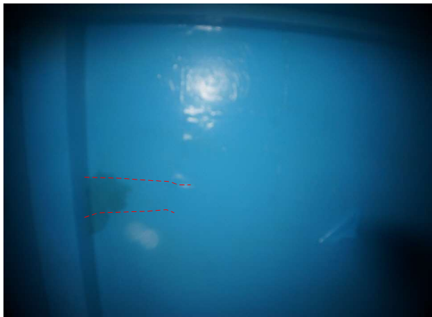
배수지1지 상부슬래브 균열(0.3mm미만)
