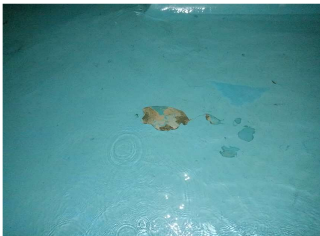
배수지1지 바닥슬래브 도장박리
