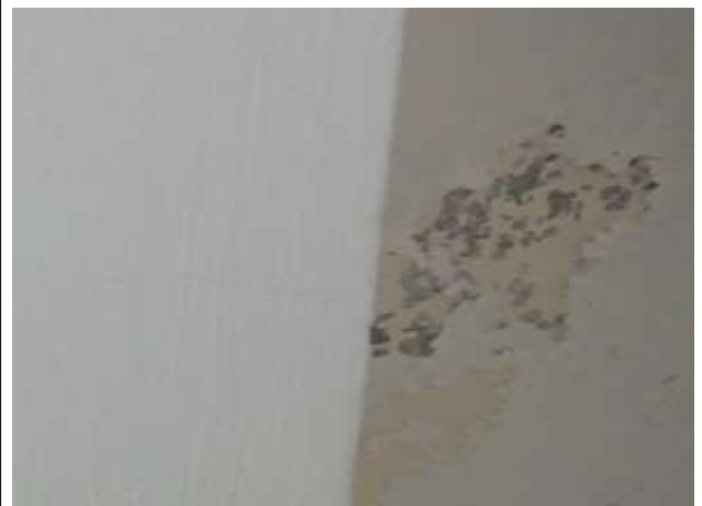
검수실 내부 상부슬래브 도장박리
