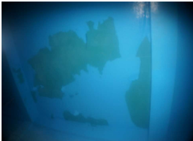
배수지1지 상부슬래브 도장박리
