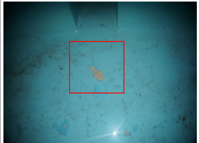
배수지2지 바닥슬래브 도장박락
